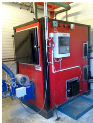
Aplicaciones en caldera
